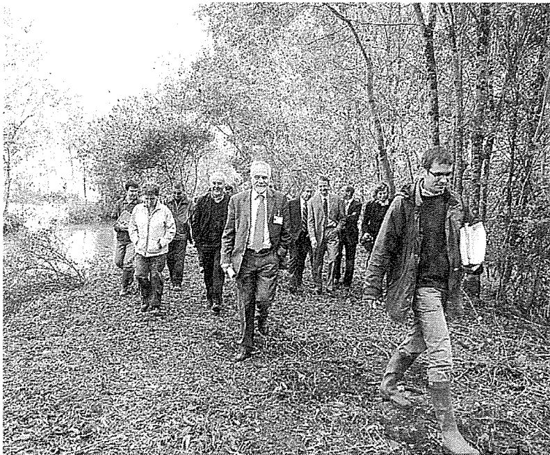
Élus et représentants du parc visitent les travaux de restauration de la rigole d'Aziré.
